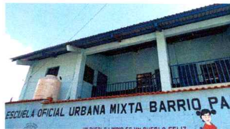
Foto 2: FALTA DE CANAL, EL AGUA CAE A LAS AULAS DE LA PARTE INFERIOR
