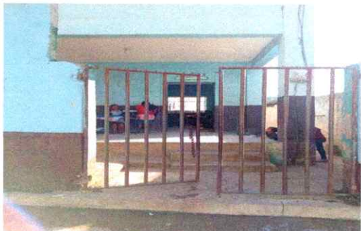
Foto1: PORTÓN EN MAL ESTADO
