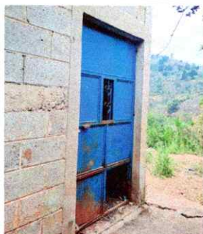
Foto 3: PUERTAS EN MAL ESTADO
