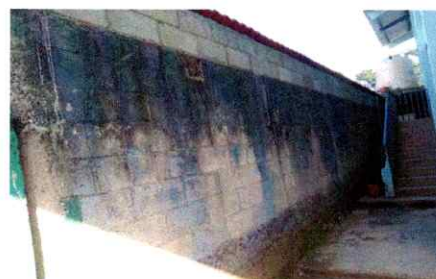
Foto 4: LA CAIDA DE AGUA Y LA FALTA DE CANAL AFECTA EL MURO
