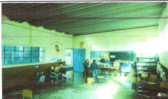
Foto1: CUBIERTA DE TECHO Y ESTRUCTURA DEL TECHO ES NECESARIA LA ESTRUCTURA PORQUE NO CUENTA CON ELLA.
