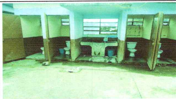
Foto 3: SERVICIOS SANITARIOS Y SUS ACCESORIOS
