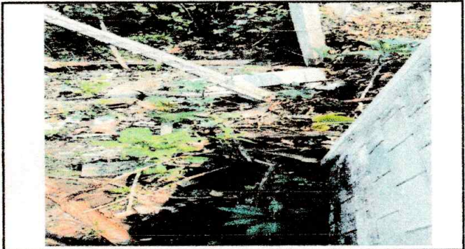
FOTO NO 1: SE OBSERVA MURO O CERCO PERIMETRAL EN MAL ESTADO.
