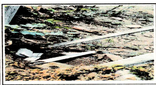
FOTO NO 5: SE OBSERVA MURO DE CONTENCION EN MAL ESTADO
