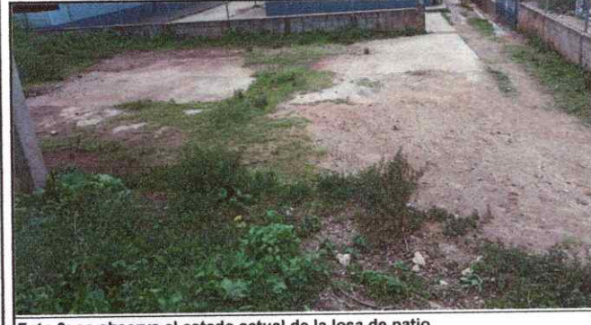
Foto 3: se observa el estado actual de la losa de patio
