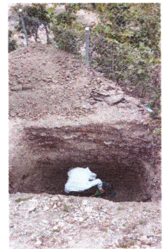
Foto 4: PARA EL CORRECTO FUNCIONAMIENTO DE LOS DOS SANITARIOS NUEVOS ES NECESARIO LA INSTALACION DE UN NUEVO SISTEMA DE DRENAJE YA QUE EL ACTUAL SON BAÑOS SEPTICOS.
