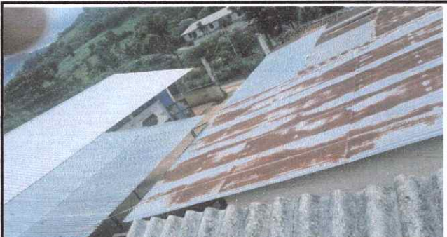
Foto 2: lamina en mal estado que requiere sustitución.
