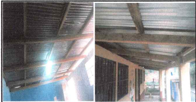
Foto 3: Estructura de techo, en mal estado que requiere sustitución.
