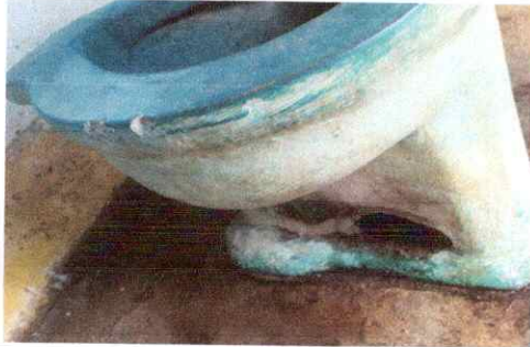
Foto7: Servicios sanitarios y sus accesorios
