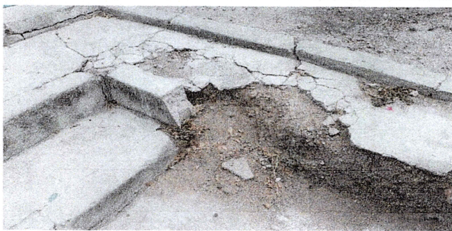
Foto: 5 Losa de patio con grietas y quebraduras.
