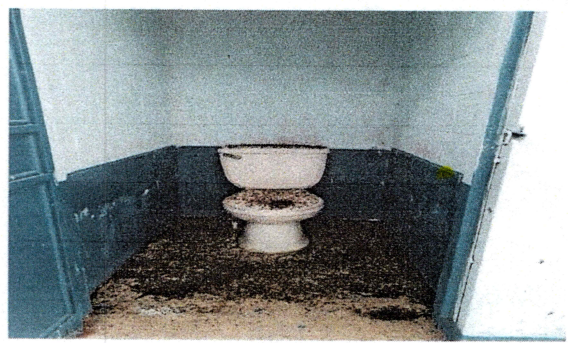
Foto 4: Sanitarios en mal estado.
