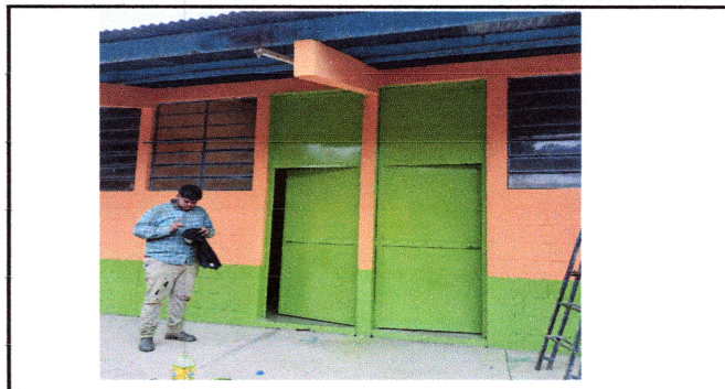
FOTO 2: Puertas oxidadas y corrosionadas. Ya pintadas y restaurada en buen estado.
