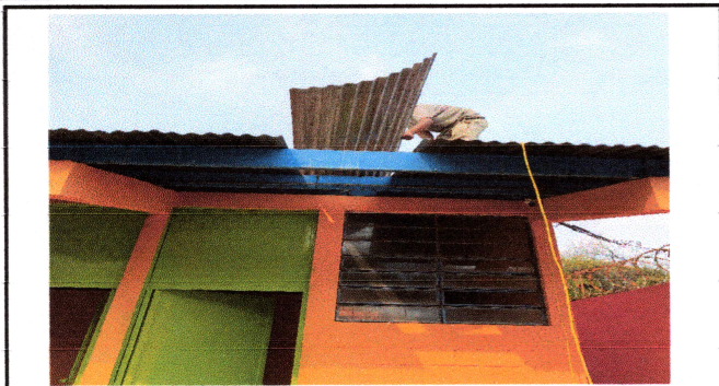
Foto1: Sustitución de lámina en mal estado con agujeros.
