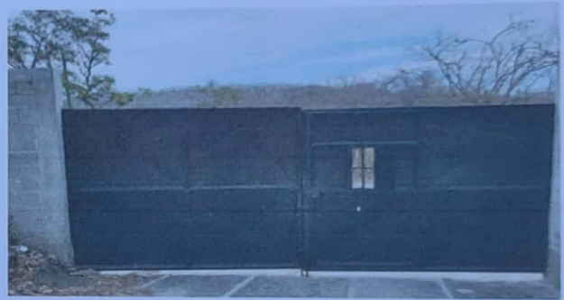
Foto 4: Portón de entrada desnivelado.
