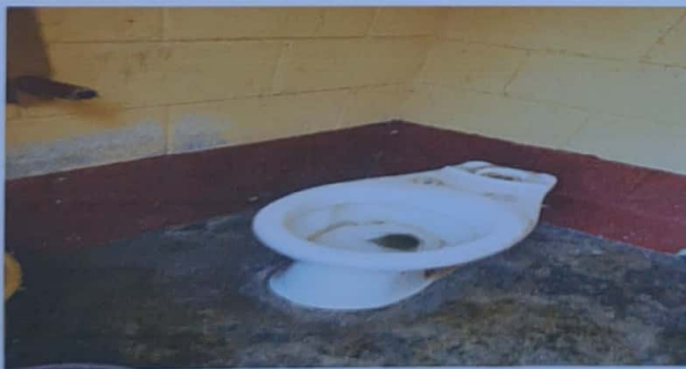
Foto: 5 Sanitarios deteriorados.
