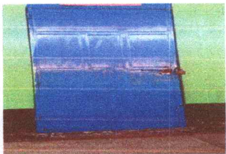
Foto 9: Puertas de aula dañadas.
