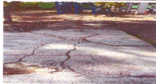
Foto 2: Losa de patio en malas condiciones .
