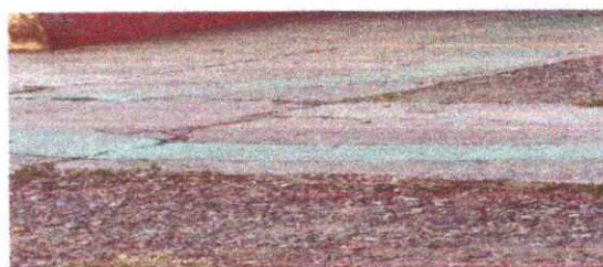
FOTO 12: LOSA DE PATIO ENTRADA A LA ESCUELA DAÑADA
