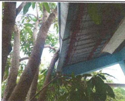
Foto 3: CANALES Y BAJADAS DE AGUA PLUVIAL (Sustitución)
