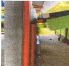
Foto 5: CANALES Y BAJADA DE AGUA PLUVIAL (CAMBIAR CANALES)
