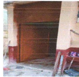
Foto 2: PUERTAS (REPARAR, PINTAR, CAMBIAR CHAPAS)
