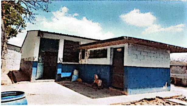
Foto1: Falta de Sistema y sistema para agua
