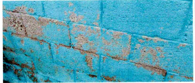
FOTO 2: Pintura en muros interiores y exteriores por deterioro.
