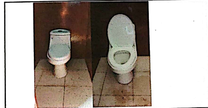
Foto 6: SERVICIOS SANITARIOS Y SUS ACCESORIOS
