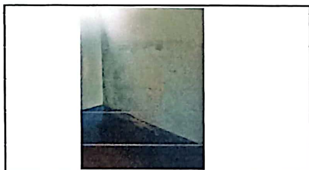
Foto: 6 Se evidencia pared en mal estado debido a la humedad.
