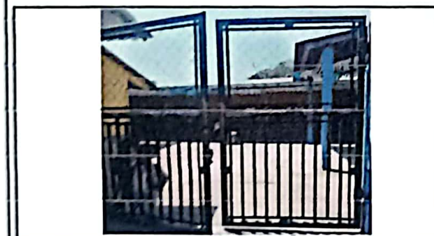
Foto: 5 Se observa portón en mal estado.
