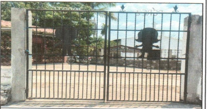
Pintura en porton
