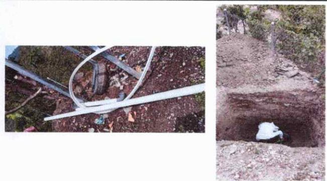
Foto 4: PARA EL CORRECTO FUNCIONAMIENTO DE LOS DOS SANITARIOS NUEVOS ES NECESARIO LA INSTALACION DE UN NUEVO SISTEMA DE DRENAJE YA QUE EL ACTUAL SON BAÑOS SEPTICOS.
