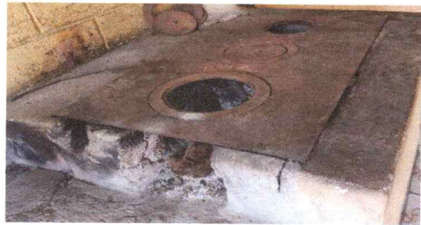
Foto 10: Se observa estufa rural en mal estado
