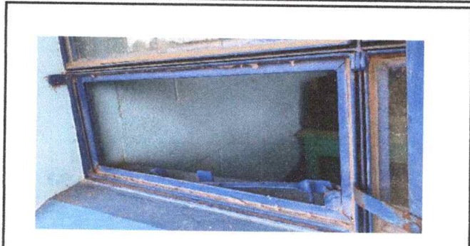
Foto 2: se evidencia ventana deteriorada
