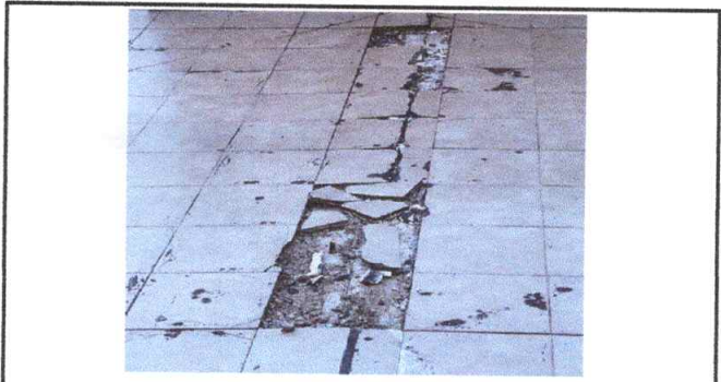
Foto 3: Se observa piso en mal estado
