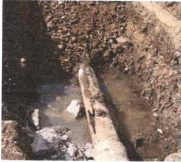
Foto 7: sistema de drenaje destruido
