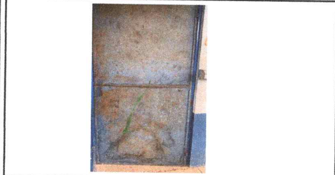
Foto1: Se observa puerta en mal estado
