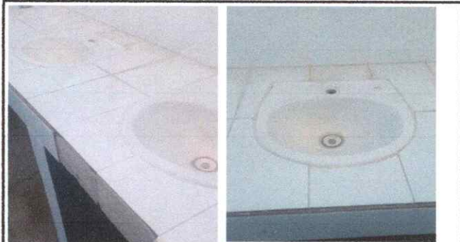
Foto 3: Se observan los chorros destruidos
