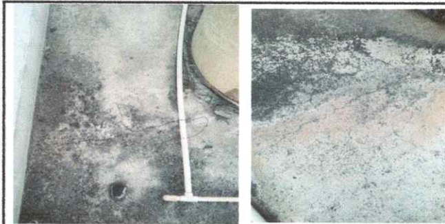
Foto1: Se observa gretaduras en la terraza.
