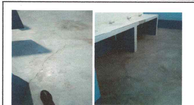
Foto 2: El piso de cemento engretado
