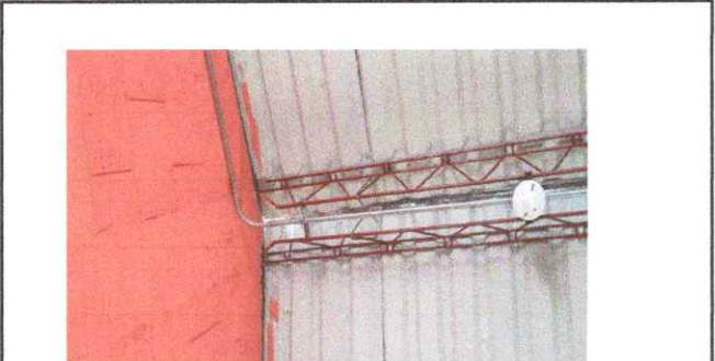
Foto 2: SE OBSERVA CUBIERTA DE TECHO DAÑADO.
