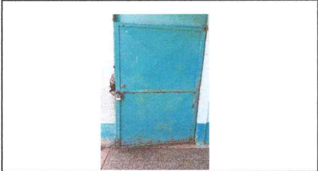
Foto3:SE EVIDENCIA PUERTA EN MAL ESTADO.
