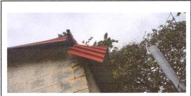
Foto1:SE OBSERVA CUBIERTA DE LAMINA EN MAL ESTADO.
