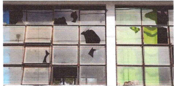
Foto4: se observa las ventanas rotas
