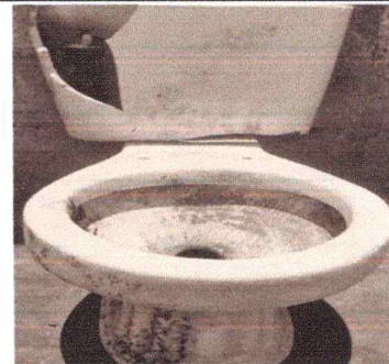
Foto: 6 Se observa los sanitarios en mal estado
