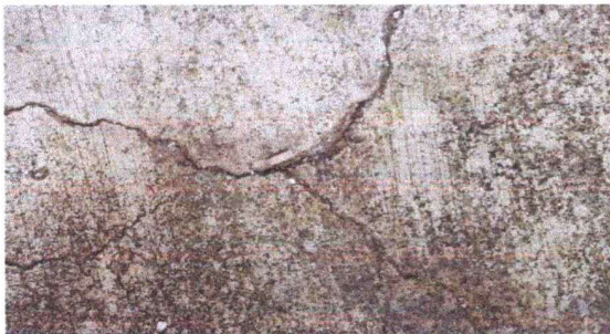
Foto: 5 se observa el piso en mal estado
