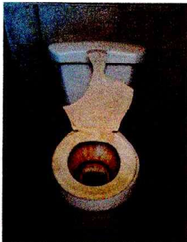
Foto 3: SANITARIOS EN MAL ESTADO
