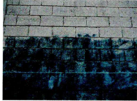
Foto 2: AULAS CARECEN DE PINTURA
