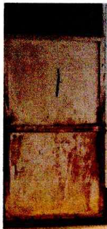
Foto 5: PUERTAS DE AULAS EN MAS ESTADO
