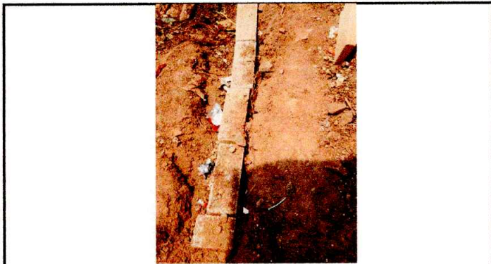
Foto 3: Muro perimetra en mal estado.
