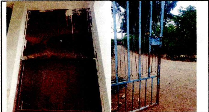
Foto 4: Es necesario nueva pintura en las puertas.
