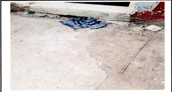
Foto 2: Losa de patio en mal estado.
