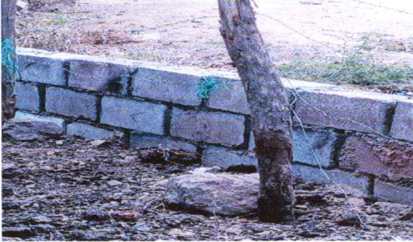
Foto 1: SE ENCUENTRA EN MAL ESTADO EL MURO PERIMETRAL
