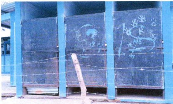
Foto 5: PUERTAS DEL BAÑO DETERIORADAS
