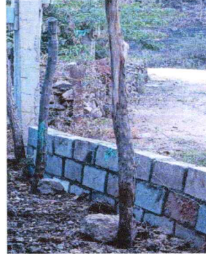
Foto 2: NO SE FINALIZÓ EL MURO PERIMETRAL
