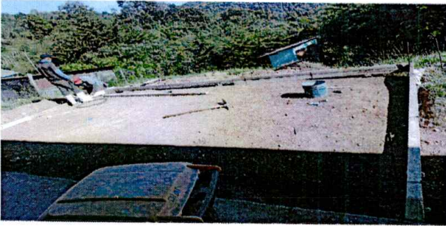
Foto 3: Reparación de losa de patio en mal estado
