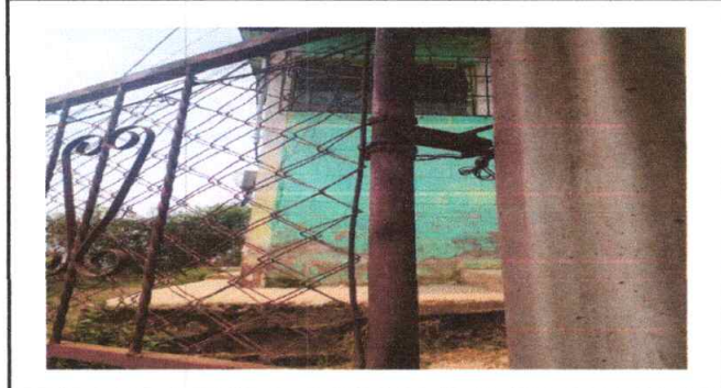
Foto 2: SE OBSERVA PORTON CON SOLDADURA DESPRENDIDA
