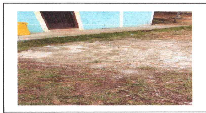
Foto 6: LOSA DE PATIO EN MAL ESTADO
