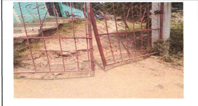
Foto1: ES NECESARIO CAMBIAR EL PORTON POR DETERIORO
