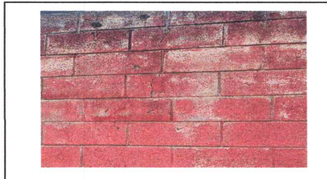
Foto 2: SE OBSERVA RAJADURAS EN MURO DE CONTENCION (DEMOLER)
