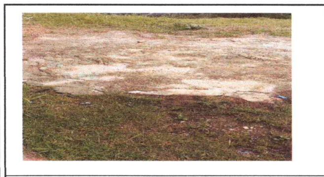
Foto 5: SE OBSERVA LOSA DE PATIO EN MAL ESTADO
