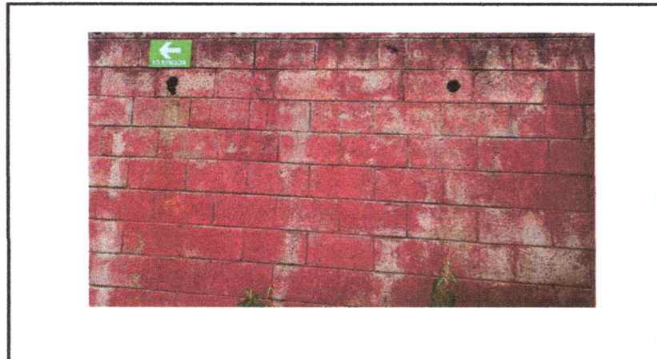
Foto 3: SE OBSERVA AGUJEROS Y GRIETAS EN MURO DE CONTENCION ( DEMOLER)
