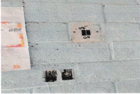
Foto1: Sistema eléctrico deteriorado e inservible .
