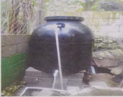
Foto7: Depósito de Agua
