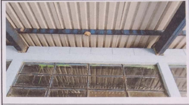
FOTO 2: Se observa falta de vidrios y vidrios en mal estado
