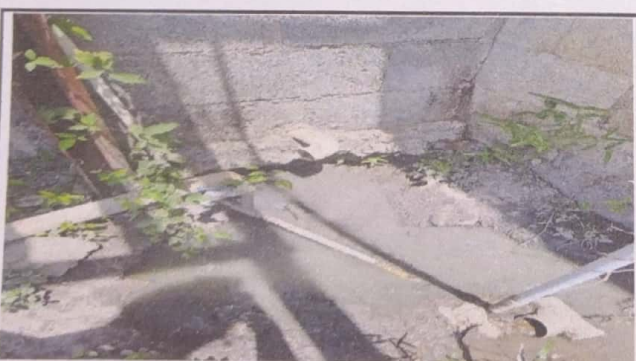
Foto 5 Se observa el drenaje en mal estado
