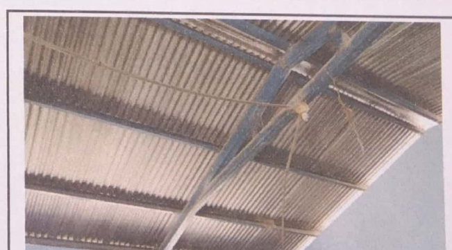
Foto: 6 Se observa el cableado inservible para su uso
