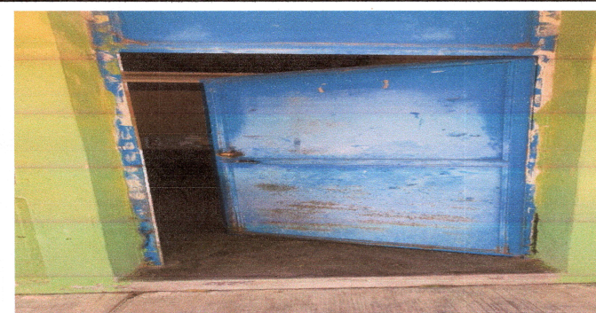
Foto 5: PINTURA DE PUERTAS EN MAL ESTADO
