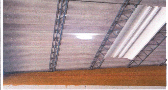
Foto 2: DURALITA EN MAL ESTADO
