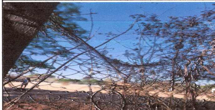
Foto 6: MALLA EN MUY MAL ESTADO
