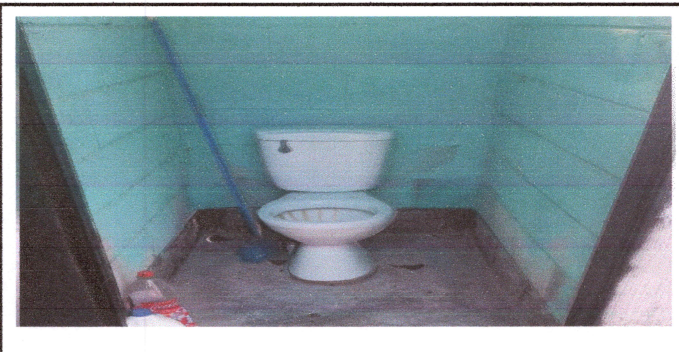
Foto 4: SANITARIOS EN MAL ESTADO
