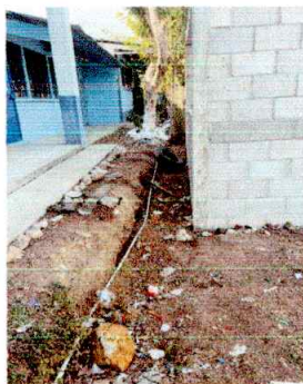
Foto 9: TUBERIA EN MAL ESTADO
