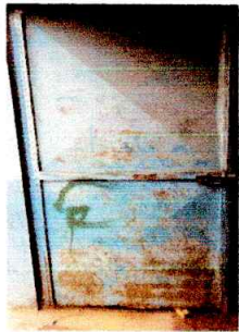
Foto 3: PUERTA DETERIORADA.. YA NO CIERRA BIEN
