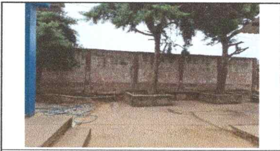
Foto 6: el muro exterior necesita pintura.
