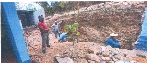
Foto 5: Corte nivelación a plomo de muro de contención previo a su fundición.
