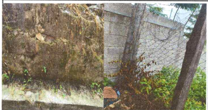
Foto 2: Muro perimetral cerca mal estado
