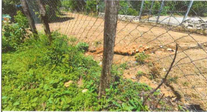
Foto 1: Muro Perimetral en mal estado
