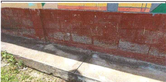
Foto 6: Pintura de aceite en mal estado
