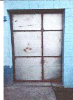
Foto 2: SE OBSERVA PUERTA DE TUBO Y LÁMINA INSEGURA
