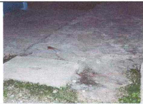
Foto 6: LOSA DE PATIO EN MAL ESTADO
