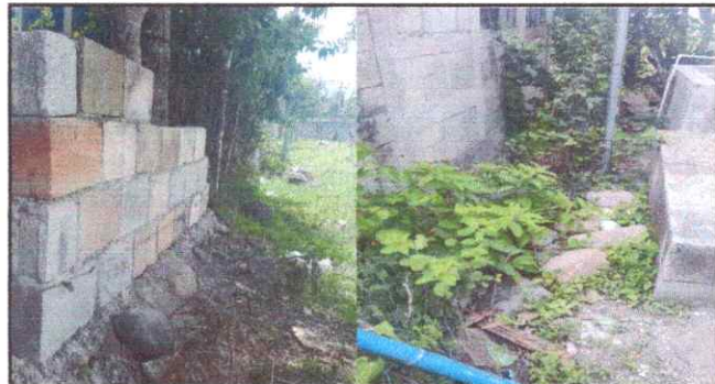
Foto 4: SE OBSERVA EN MAL ESTADO EL MURO DE BLOCK Y MALLA
