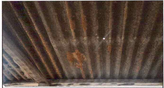
Foto 2: SE OBSERVA LA COSTANERA DE MADERA EN MAL ESTADO
