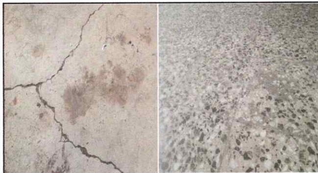
Foto 3: EVIDENCIA DEL MAL ESTADO EL PISO DE CEMENTO Y EL PISO DE GRANITO BASTANTE DESGASTADO
