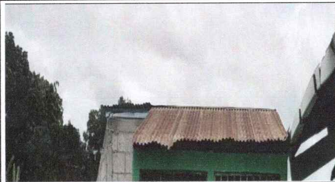
Foto 1: SE OBSERVAN LAMINA ACANALADA CON OXIDO Y SE PRODUCEN FILTRACIONES
