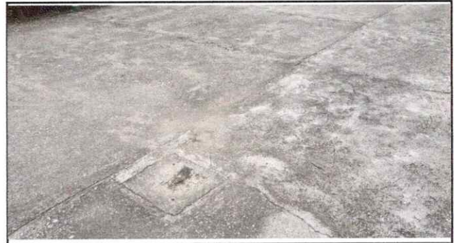
Foto 4: SE OBSERVA LOSA DE PATIO EN MALAS CONDICIONES
