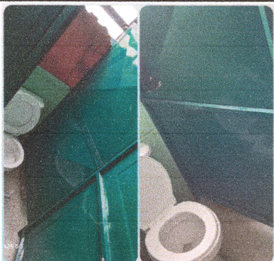
Foto 3: SERVICIOS SANITARIOS Y SUS ACCESORIOS
