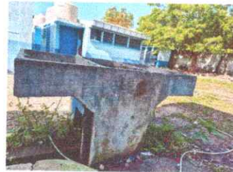
Foto 2: la red de agua potable se encuentra totalmente en mal estado teniendo que utilizar mangueras para mantener el agua para uso de los niños, por estar al interperie se daña frecuentemente, siendo importante las sustitución de la red existente.
