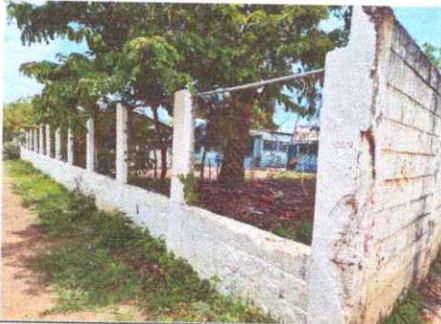
Foto 3: El cerco perimetral es de suma importancia para seguridad de los estudiantes y areas de estudio de los mismos por tanto es una de las necesidades primordiales el poder reparar y dar mantenimiento al mismo.
