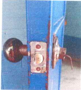
Foto 1: sustitución de chapas para 5 aulas que se encuentran totalmente en mal estado quedando inseguras por lo que es necesario la sustitución.
