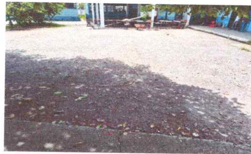
Foto 4: La losa existente se encuentra en mal estado ocasionando accidentes a los estudiantes, siendo esta área el unico espacio que se cuenta para la recreación de los estudiantes por lo que es de suma importancia para
