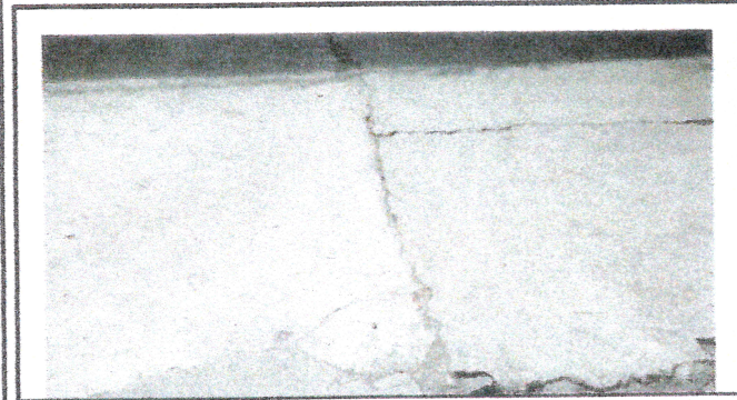
Foto3: Losa de patio en mal estado
