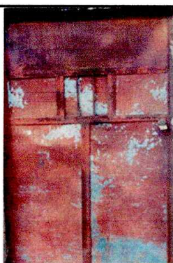
Foto 3: SE OBSERVA PUERTA DETERIORADA (SUSTITUCIÓN)
