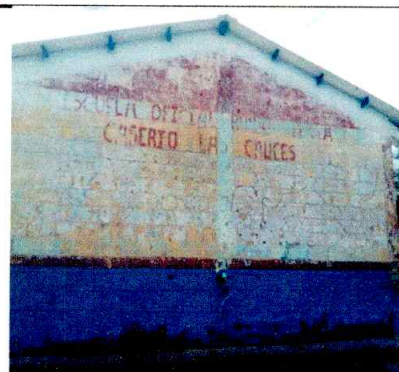
Foto 4: SE OBSERVA DETERIORO DE PINTURA (SUSTITUCIÓN)
