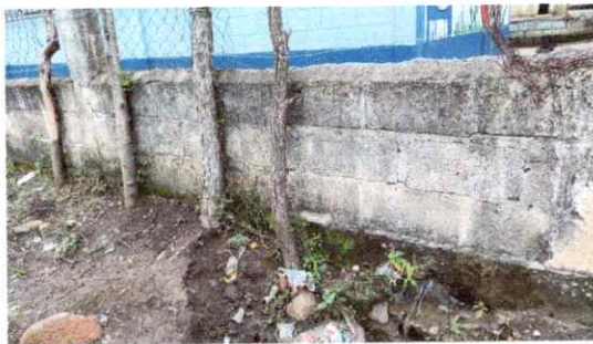
Foto 5: Muro Perimetral desplomado y malla dañada.
