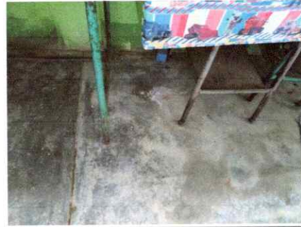
Foto 2: Paredes húmedas por problema de exceso de humedad.
