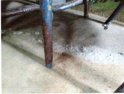
Foto1: Problema de humedad y hongo visible.
