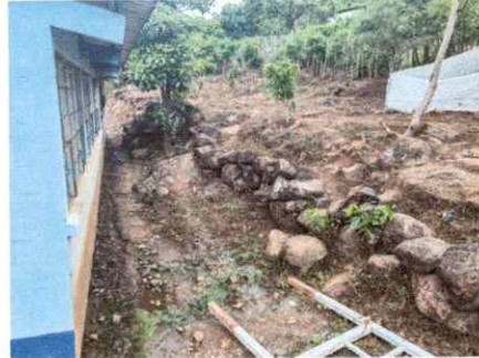
Foto 4: Problemas de exceso de humedad en pared.
