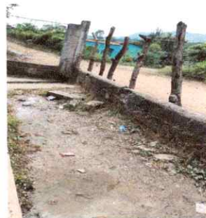
Foto 6: muro perimetral dañado.
