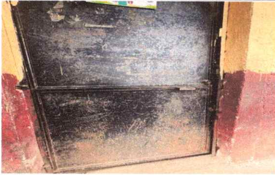
Foto 3: Puerta en mal estado.
