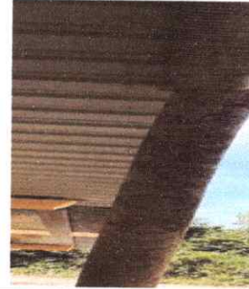
Foto 8: Bajada de agua en mal estado.
