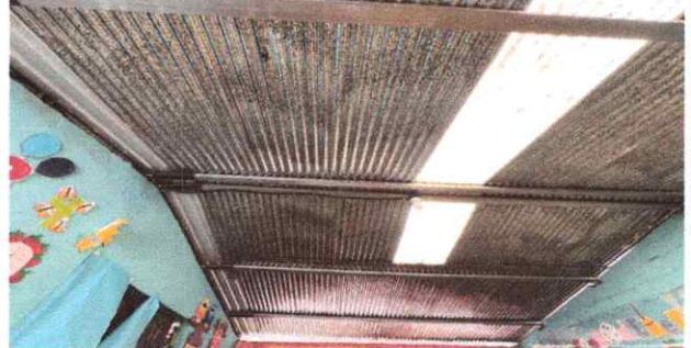
Foto 2: Falta de soporte a la estructura.
