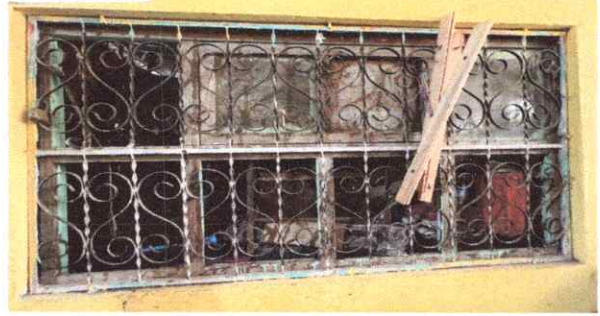
Foto 4: Ventana en mal estado.
