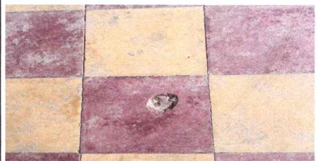
Foto 6: Piso en mal estado.
