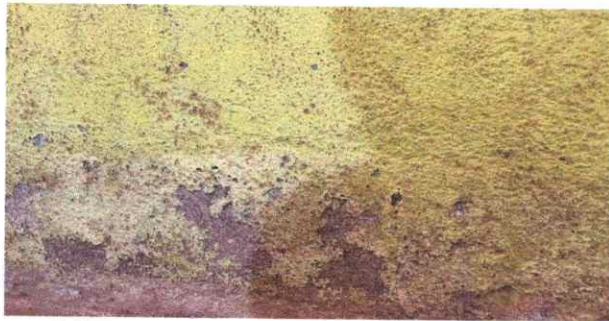
Foto 9: Repello en mal estado.
