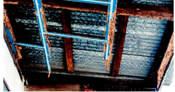
Foto 2: ES NECESARIO CAMBIO DE ESTRUCTURA EN COCINA
