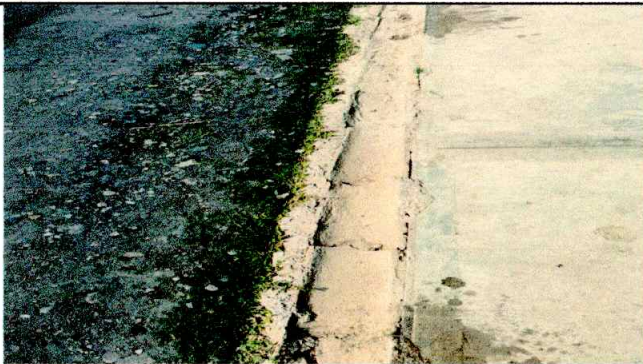
Foto 3: SE OBSERVA CUNETA EN MAL ESTADO
