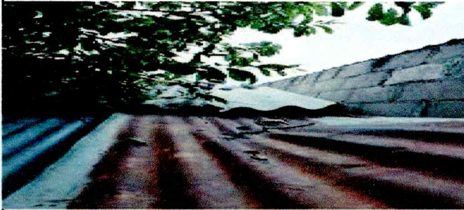
Foto 1: SE OBSERVA CUBIERTA DE LAMINA DAÑADA
