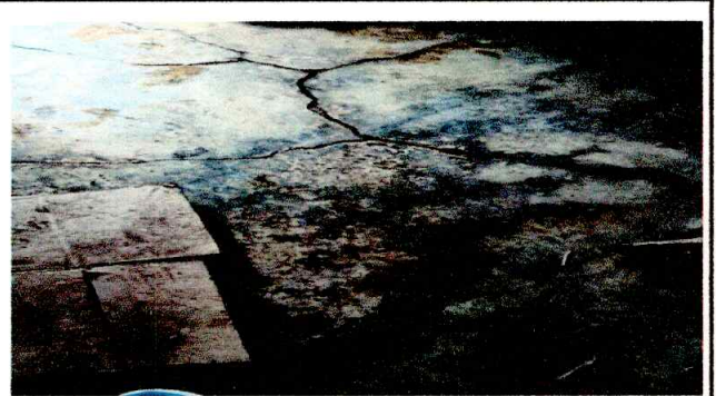
Foto 6: SE OBSERVA LOSA DE PATIO EN MAL ESTADO
