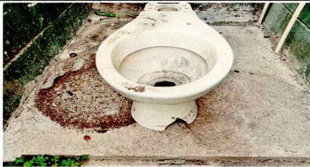
Foto 5: SE OBSERVA BAÑOS DAÑADOS
