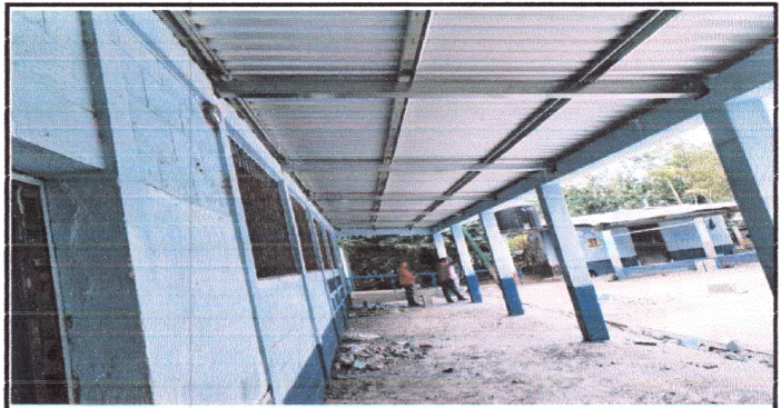
Foto 2: Estructura y cubierta de lámina reparada de los corredores del centro educativo.
