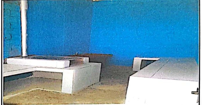
Foto 2: sustrucción de área de cocina
