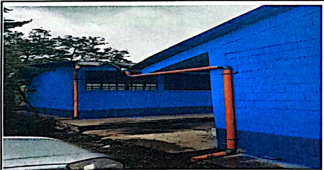
Foto 5: canales y bajadas de sgua
