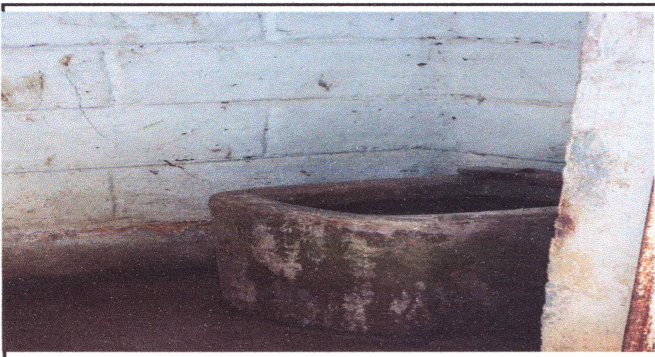
Foto3: inodoros en pesimas condiciones
