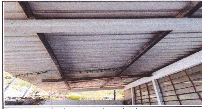
Foto: 6 sistema electrico es necesario remplazarlo
