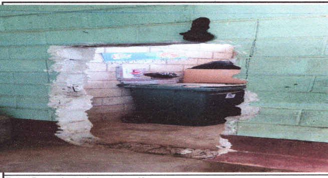
Foto: 5 pared requiere reparación
