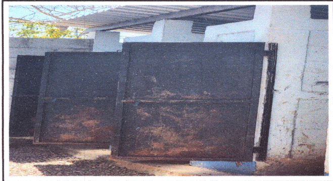
FOTO 2: necesidad de reparación de puertas
