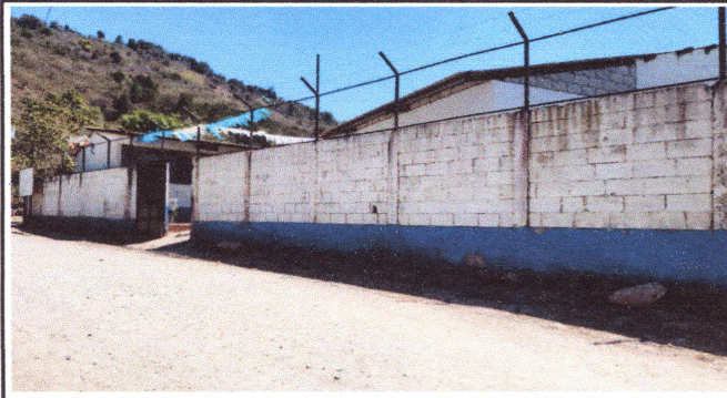
Foto1: paredes en mal estado
